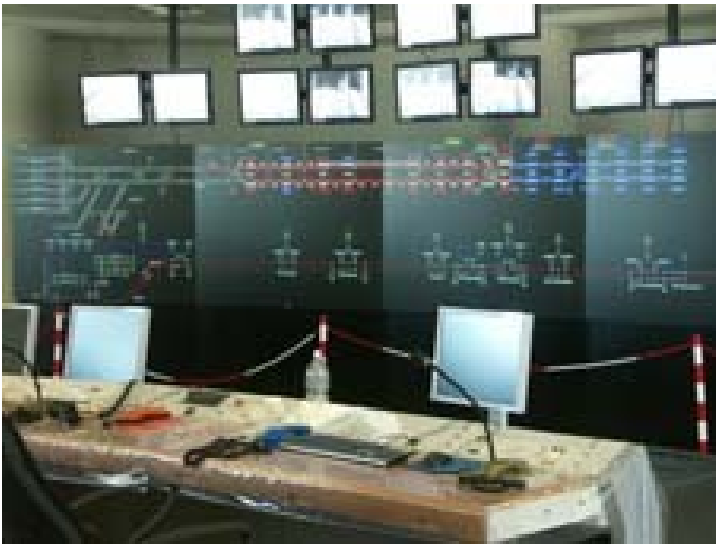
Sala controllo del PCC.
