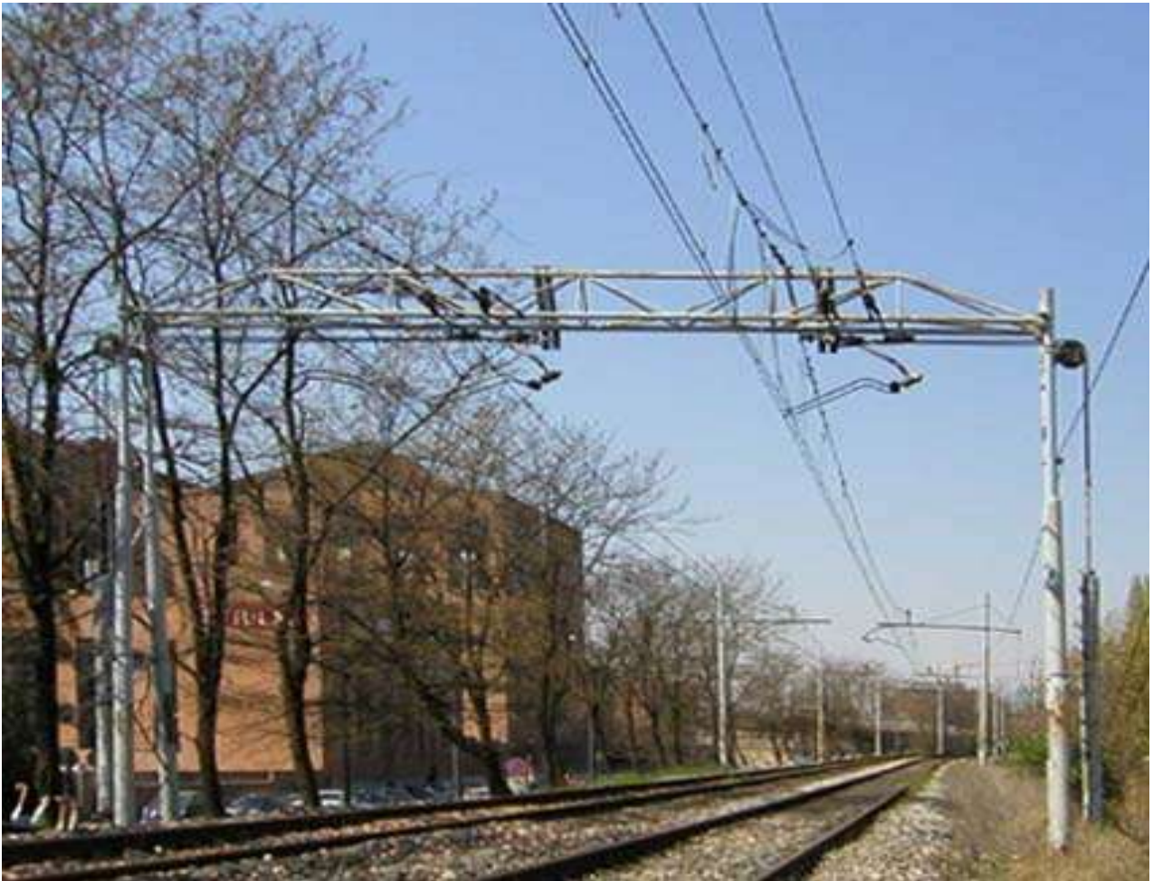
Un esempio di portale a sezione triangolare presente fino a febbraio 2006 sulla tratta Milano S.Cristoforo -Mi Porta Romana (demolito nel corso dei lavori per la creazione della fermata di Romolo della linea suburbana S9)
