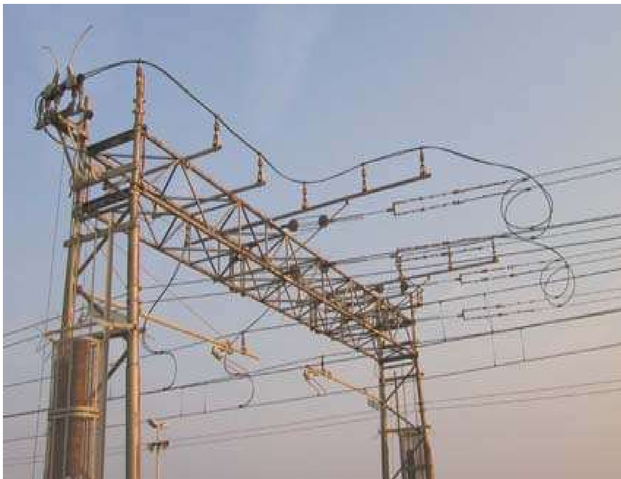
Portale FS a Bordighera: notare i sezionatori per l'isolamento della stazione.
