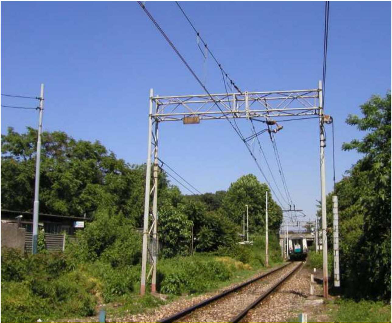
Portale a traliccio quadrato sulla tratta Milano Porta Genova- MI S. Cristoforo
